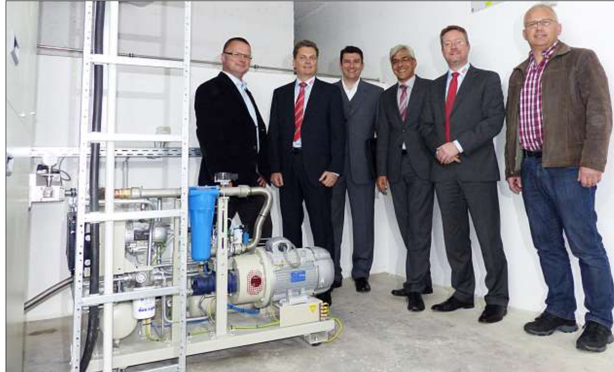
Bei der Besichtigung im Turbinenraum: (von links) Ralph Hüsgen, Thomas Grün (beide ERN), Erik Reiß (Institut für Energie und Umwelt), Thorsten Kilwing (Diakonie), Tilman Kabella (ERN) und 2. Bürgermeister Johann Kaisersberger. – Foto: Kolb
